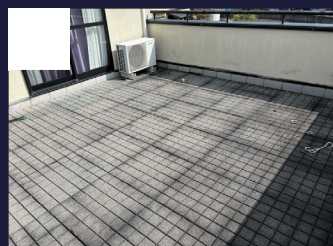
バルコニーの劣化
